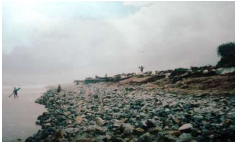
Hình 3. Khối gia cố mái bị sóng rút kéo ra phía ngoài
