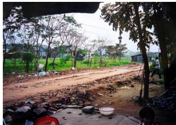
Hình 4. Đường xá chưa hoàn thiện khi dân đã sinh sống (Kim Long, Tp. Huế)
