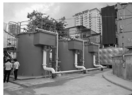
Hình 2. Hệ thống Chemiles tại Nhà máy nước Tương Mai
