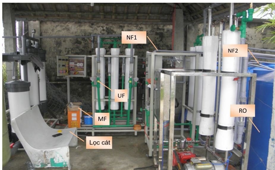
Hình 3. Mô hình nghiên cứu xử lý nước mặn và nước lợ lắp đặt tại hiện trường
