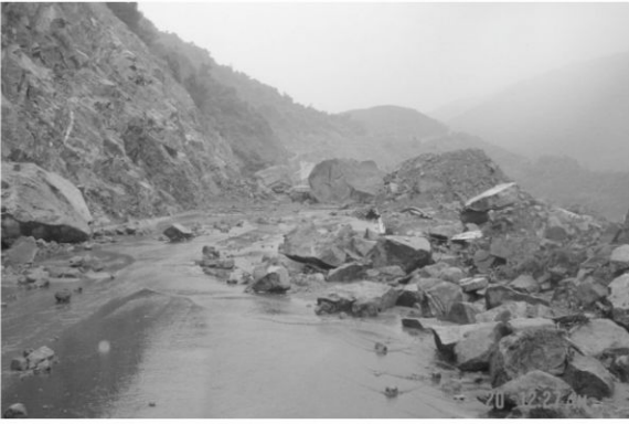
Hình 1. Ta luy đào sâu, đắp cao luôn là mối đe dọa đối với điều kiện khai thác của tuyến đường
