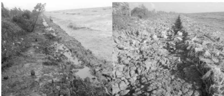
Hình 1. Kè rọ đá bị phá hủy (thép làm rọ đá đã được bọc polyme)
