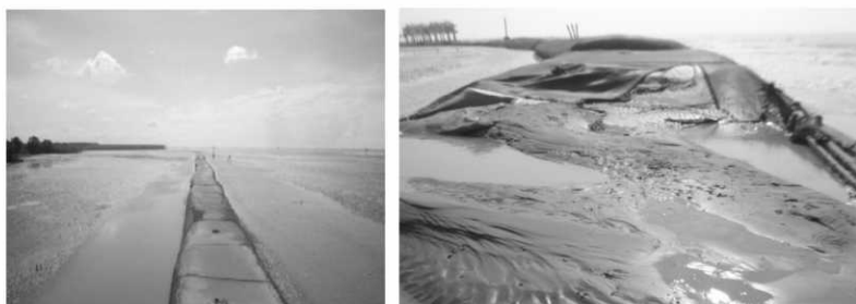
Hình 2. Kè bằng ống vải địa kỹ thuật nhồi bùn cát bị phá hủy do tác động cơ học
