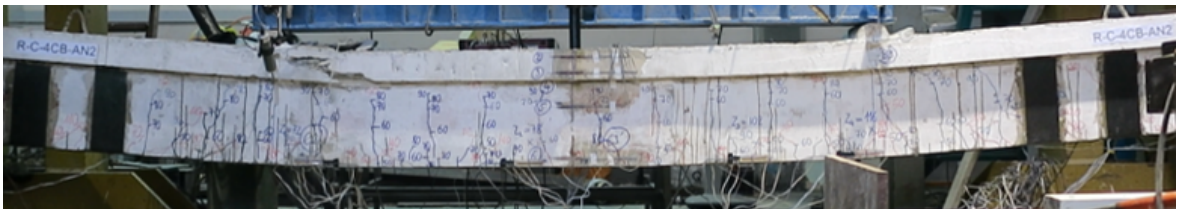
(d) Dầm RC4-AN2 bị nén vỡ bê tông vùng nén và liền sau đó là bong tách tấm CFRP trong nhịp uốn
