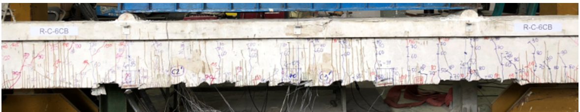
(c) Dầm RC6 bị bong tách tấm CFRP trong nhịp cắt và lớp bê tông bảo vệ trong nhịp uốn
