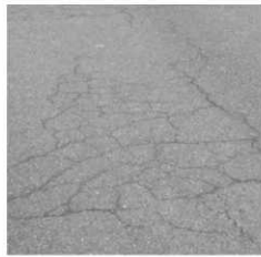
a) Nứt mặt đường bê tông
