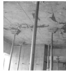
c) Nứt sàn nhà cao tầng
