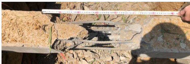
(a) Cấu kiện BTCT số 2
