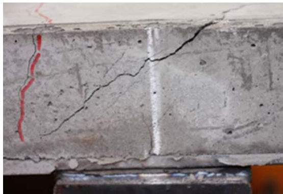
(b) Phá hoại cục bộ của bê tông vùng gối tựa sau khi có sự bong liên kết giữa tấm tôn và bê tông
